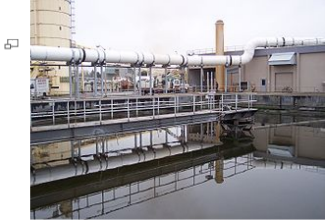
محطة لمعالجة مياه الصرف الصحي
